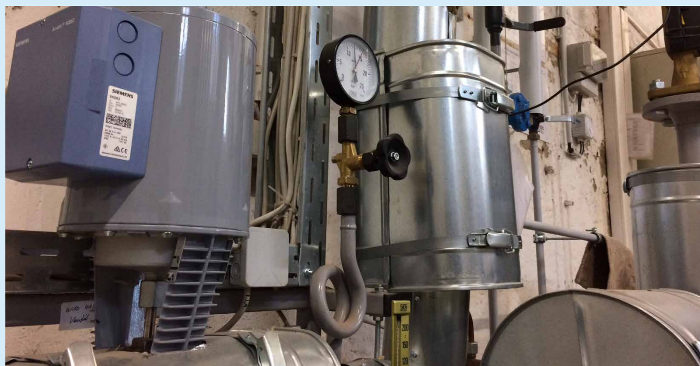
Neu eingebaute Regeltechnik zur Reduzierung des Energieverbrauchs (Quelle: Stadt Chemnitz)
