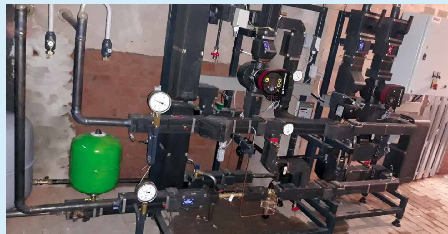
Installierte iHAST (Quelle: Stadt Chemnitz)
