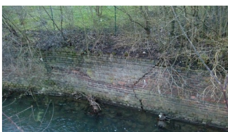
Vorhandene baufällige Ufermauer (BA 1)
