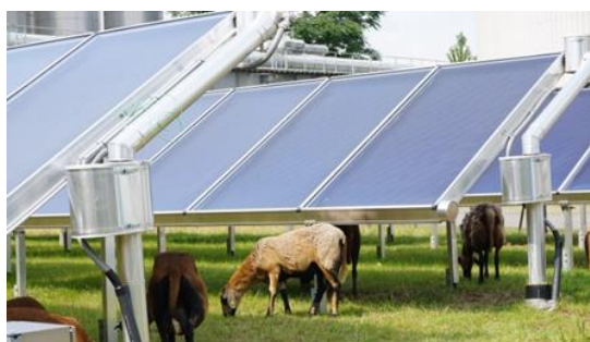
Solarthermieanlage der eins mit doppelt grüner Nutzung Foto: Stadt Chemnitz
