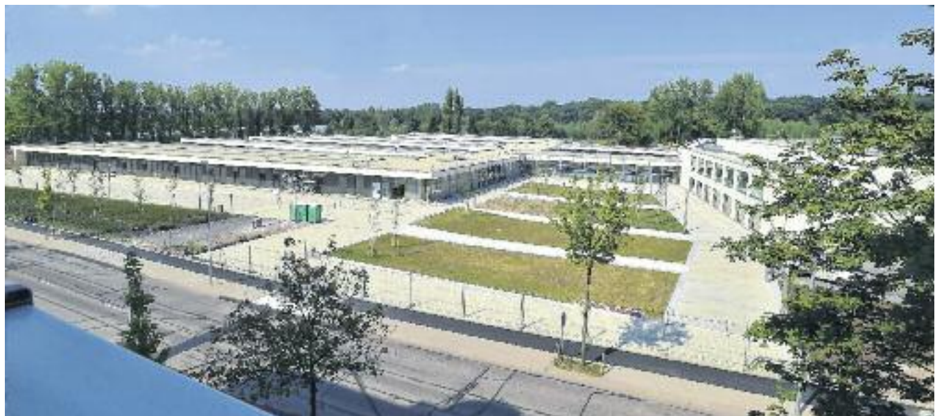
Fortschritte gibt es deutlich zu sehen, am Bau des Schulcampus auf der Heinrich-Schütz-Straße.
