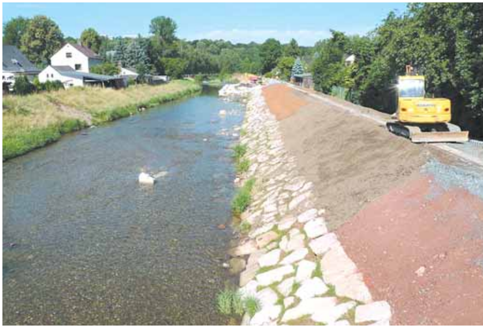
Die Flut im August 2010 richtete in Chemnitz und Umgebung enorme Schäden an. Anlass für die Stadt und das Land den Hochwasserschutz zu verbessern, wie hier in Alchemnitz. Foto: LTV
