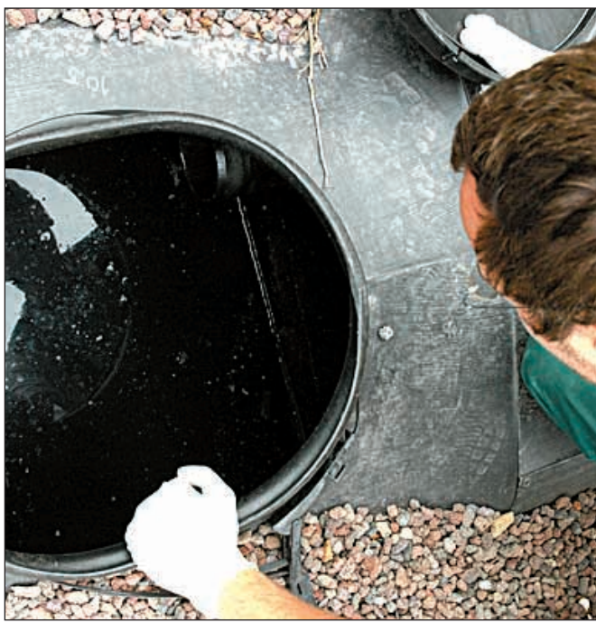
Ein Informationstag gibt Gelegenheit, sich mit den verschiedenen technischen Varianten für die Errichtung einer vollbiologischen Kleinkläranlage vertraut zu machen. Foto: ASR
