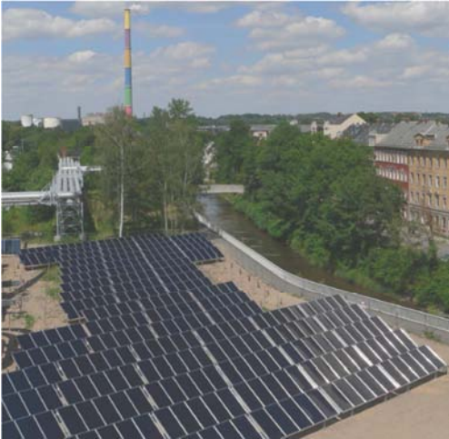
Abb. 10 Solarthermiefeld der eins
