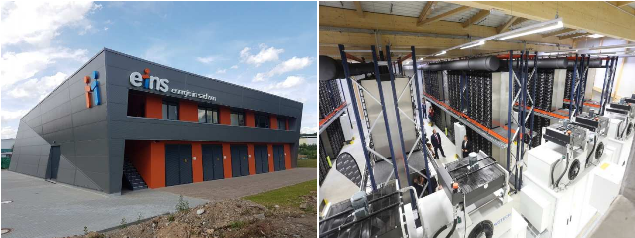
Abb. 32 Batteriespeicher am Dammweg (Quelle: eins )
