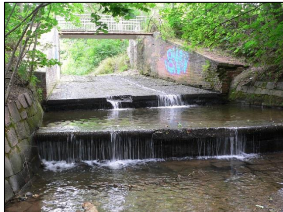
Abb. 11: Absturz am Gablenzbach
