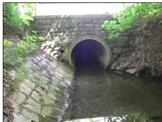
Abb. 12: Verrohrung Gablenzbach DN 1500 unter dem Balzacweg
