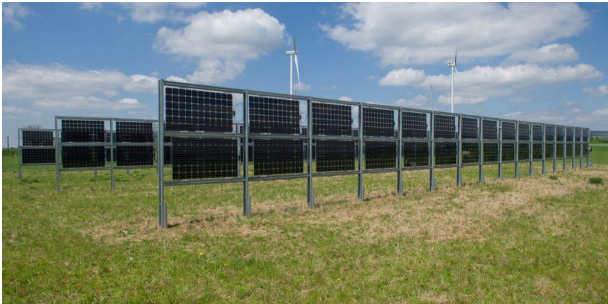
Abbildung 38: Beispiel für eine Agro-PV Anlage mit bifazialen Modulen und senkrechter Installation [68]
