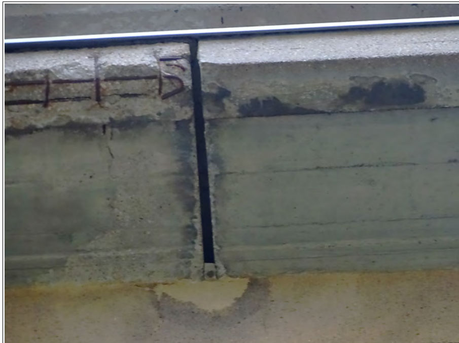
Bild 11: Spalt im Beton des Traufbereiches der Straßenfassade am Hauptgebäude - Nistplatz Mauersegler
