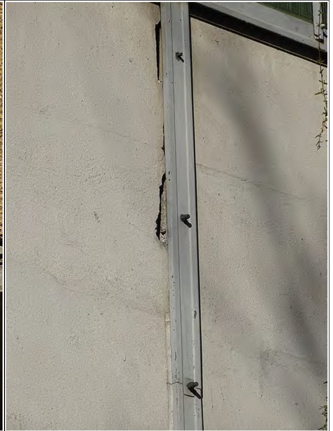
Bild 10: Risse in der Betonfassade einer Werkhalle - Nistplatz der Kohlmeise (Nr. 35)
