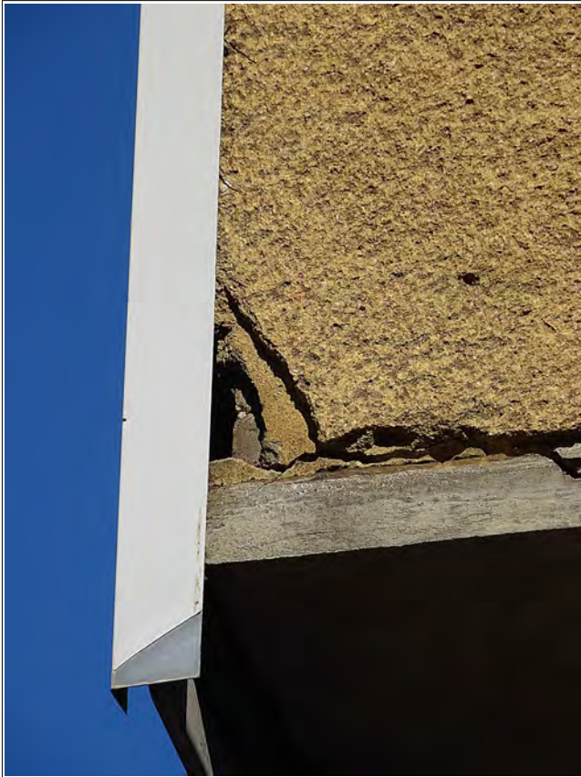
Bild 9: Bauschaden an der Fassade des Hauptgebäudes vom Spinnereimaschinenbau - Nistplatz der Blaumeise (Nr. 30)
