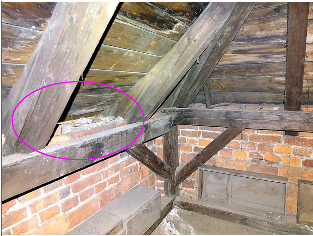
Bild 12: Innenraum des Westturmes auf dem Dach des Spinnereimaschinenbaus - offener Spalt eingekreist
